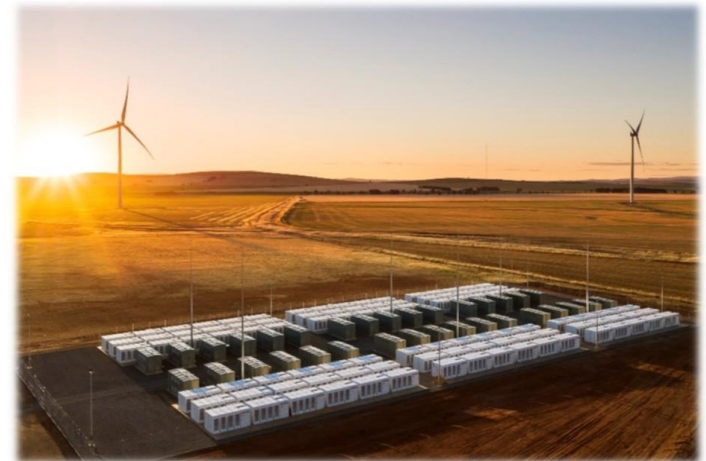
✓ Tesla Hornsdale Power Reserve 100 МВА 129 МВт·ч
